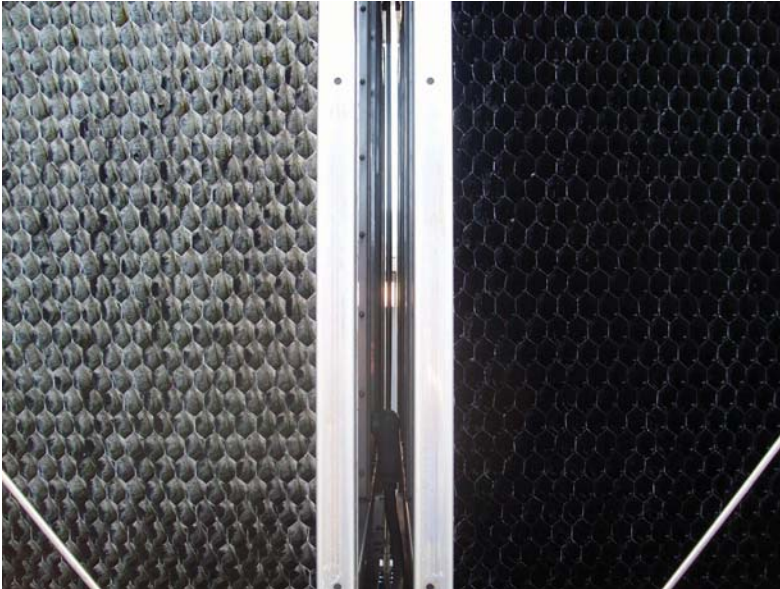
Remplissage de tour de refroidissement : Avant et après le nettoyage
