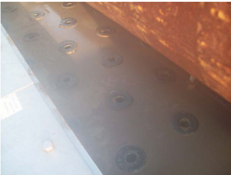
Plateau de distribution : Avant le nettoyage
